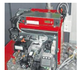
Platzsparend: die Heizung der Firma Scheer aus Wöhrden.
